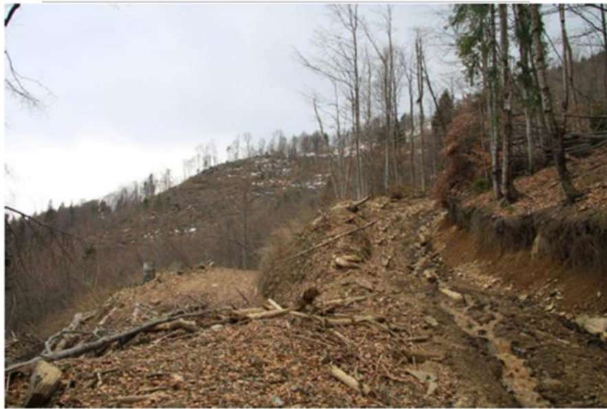
Fig. 3. Drumuri de exploatare pe versanti inclinati trasate in arborete de protectie seculare, valea Cormaia, PNMR (2018).
